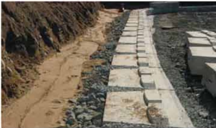
Drenering bak muren
